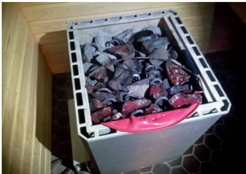
Muovinen löylykiulu jäänyt kiukaan päälle ja kiuas on mennyt ajastimella päälle. Myös muoviset mattoritat kokevat usein saman kohtalon. (Pelastuslaitoksen kuva)
